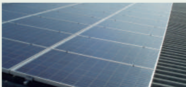
Impianto fotovoltaico - silicio policristallino
